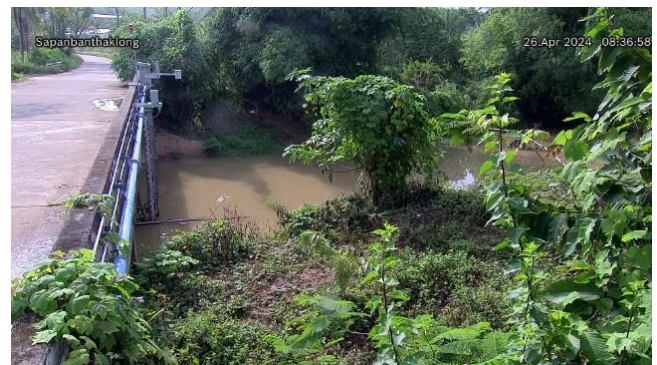
TC220512 : สะพานบ้านท่าคลอง ต.ทับปริง อ.เมืองกระบี่ จ.กระบี่
