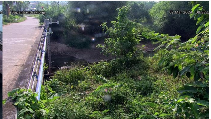
TC220512 : สะพานบ้านท่าคลอง ต.ทับปริก อ.เมืองกระบี่ จ.กระบี่
