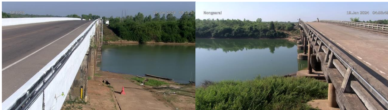
TC032705 : สะพาน นพ.4059 ต.ท่าบ่อสงคราม อ.ศรีสงคราม จ.นครพนม
