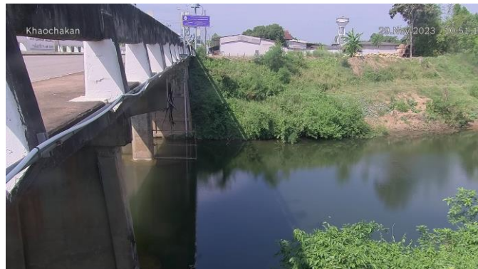
TC150105 : บ้านเก่าเขาฉกรรจ์ ต.หนองหว้า อ.เขาฉกรรจ์ จ.สระแก้ว
