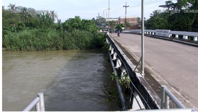
TC191001 : สะพานข้ามแม่น้ำตาปี ตลาดฉวาง ต.ฉวาง อ.ฉวาง จ.นครศรีธรรมราช
