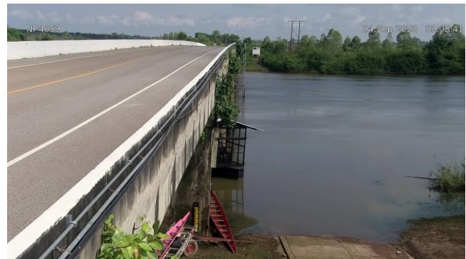
TC032705 : สะพาน นพ.4059 ต.ท่าบ่อสงคราม อ.ศรีสงคราม จ.นครพนม
