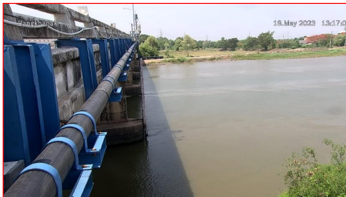
สถานีบ้านบางขนาก ต.บางขนาก อ.บางน้ำเปรี้ยว จ.ฉะเชิงเทรา (ลุ่มน้ำบางปะกง – แม่น้ำบางปะกง)
