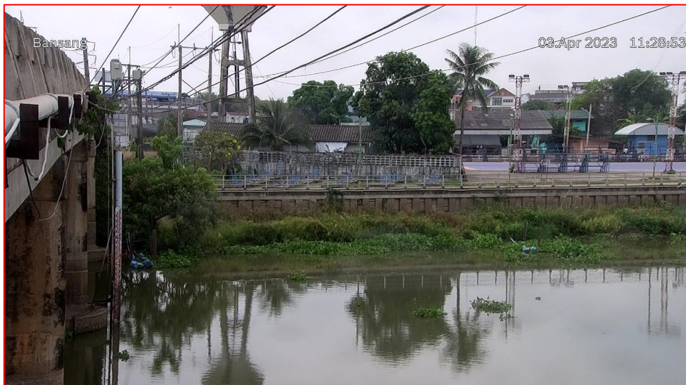
สถานีบ้านสร้าง ต.บ้านสร้าง อ.บ้านสร้าง จ.ปราจีนบุรี (ลุ่มน้ำบางปะกง – แม่น้ำปราจีนบุรีตอนล่าง)
