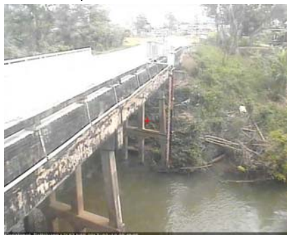
สถานีคลองตะโหมด - อ.ตะโหมด จ.พัทลุง (ลุ่มน้ำทะเลสาบสงขลา)
