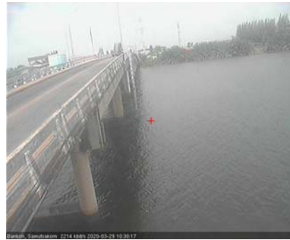
สะพานข้ามแม่น้ำท่าจีน ๓ - อ.เมือง จ.สมุทรสาคร (ลุ่มน้ำท่าจีน)
