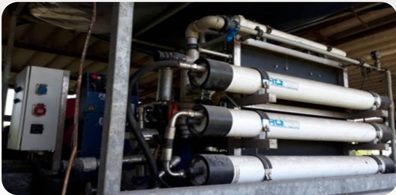
ระบบผลิตน้ำประปา ชนิด Reverse Osmosis (RO)
